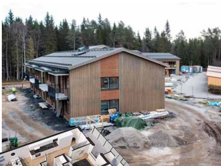
Bygget i Byske fortskrider med full fart. Det blev trevliga tvåvåningshus med en fasad klädd i trä.
